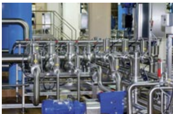
Maintenance préventive en IAA
